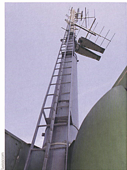
Die Wimax-Basisstation in Boltigen ist vorerst ausgeschaltet. La station de base Wimax à Boltigen est désactivée jusqu'à nouvel ordre.
