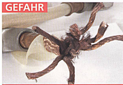
Ca. 30 Jahre alte Garnitur mit Querschnittsminderung durch Kupfer-Korrosion
