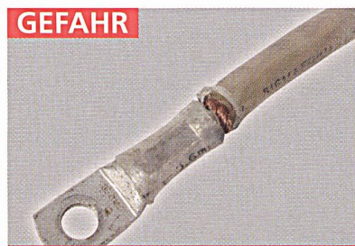
Hervortreten des blanken Leiterseils an gebrochener Seileinführung
