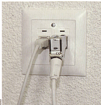
Bild 3 Steckdose mit Übergangsstück für TV-Kabel.
