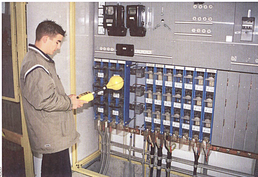
Bild 2 Magnetfeldmessung beim Elektroverteiler.
