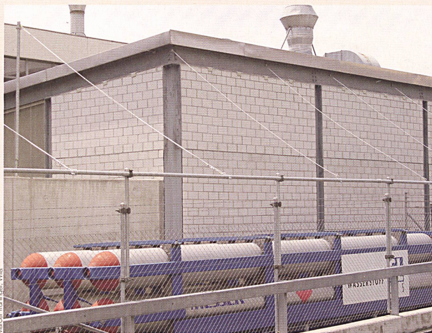
Spezielle Blitzschutzanlage über einem Wasserstofftanklager mit gespannten Fangleitungen.
