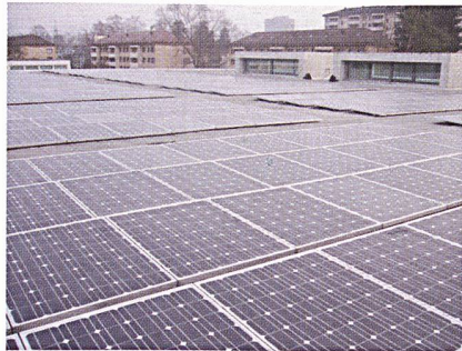
Mit dem Formsol-Integrationssystem von Zagsolar wird die Fotovoltaikanlage auf der Turnhalle Hirzenbach zum Gebäudeteil
