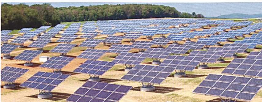
Mover: Nachgeführte Solarkraftwerke mit hohem Energieertrag («Gut Erlasee», Foto: Solon AG).
