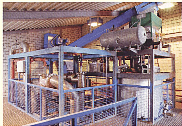
Durch die Einspeisevorrichtung gelangen die Holzsnitzel in den Holzvergaser (Bild: ekz).
