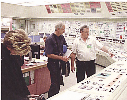
Kommandoraum im Kernkraftwerk Beznau (Bild: NOK).
