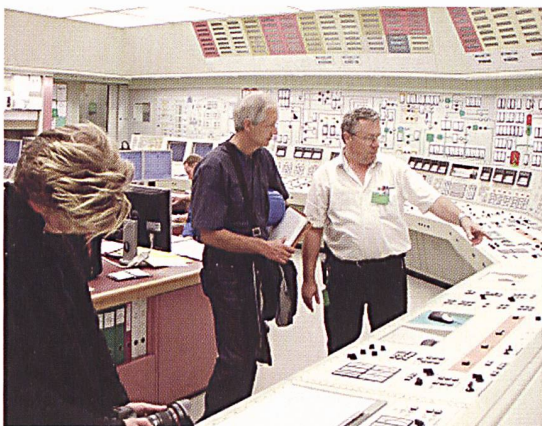
Kommandoraum im Kernkraftwerk Beznau (Bild: NOK).
