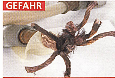
Ca. 30 Jahre alte Garnitur mit Querschnittsminderung durch Kupfer-Korrosion
