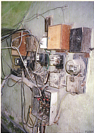
Hausanschluss und Zählerverteilung auf Kuba: nicht ganz normgerecht
