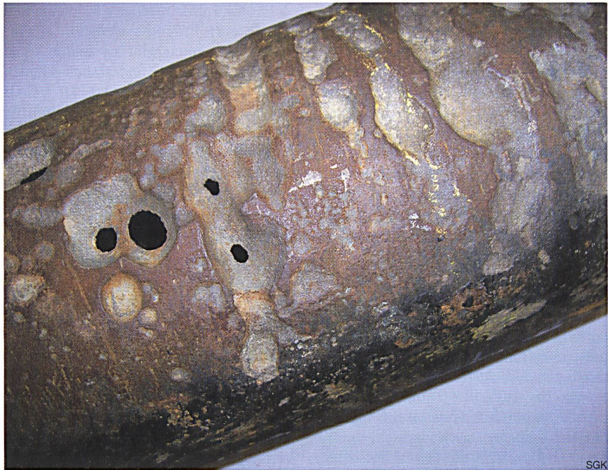
Bild 2 Korrosionsangriff an einer Wasserleitung durch Gleichströme aufgrund von elektrischer Verbindung mit einem Fundamenteerder
