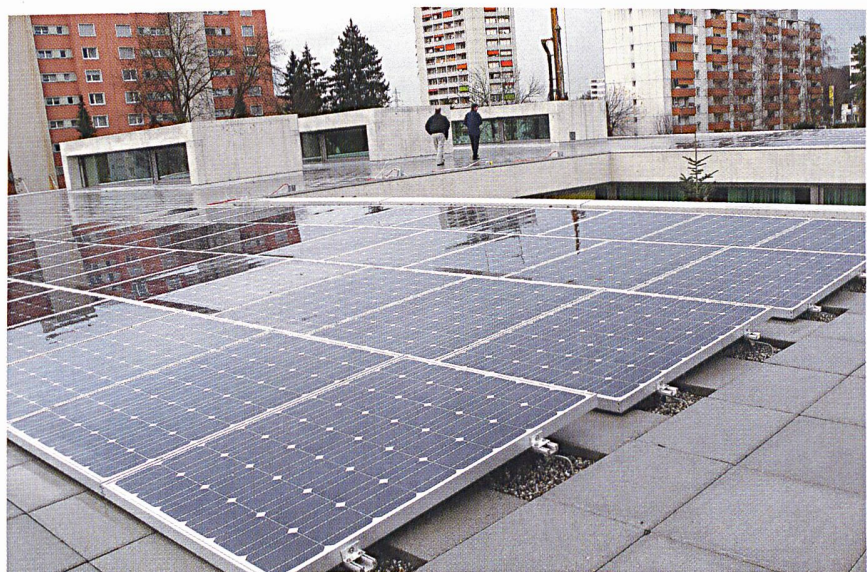
Solarpanels auf dem Dach des Kindergartens Hirzbach in Zürich (Bild: ewz).
