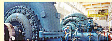
Turbinenanlage im Pumpspeicherkraftwerk Waldeck I (Bild Eon).
