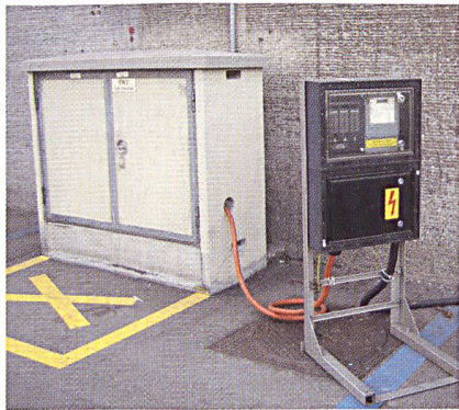
Der Bauanschluss mit Zähler regelt die Eigentumsverhältnisse klar
