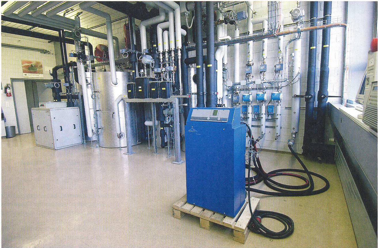
Im neuen Wärmepumpen-Testzentrum am Neutechnikum Buchs werden Wärmepumpen nach Euronorm mit modernster Messtechnik getestet und geprüft (Bild FWS).
