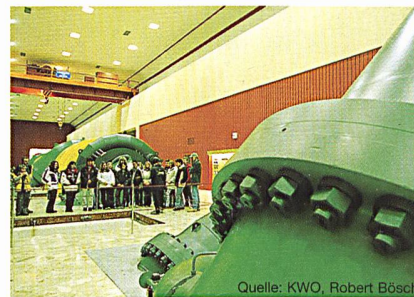
Kraftwerk Grimsel 2, Blick in die Kraftwerkskaverne
