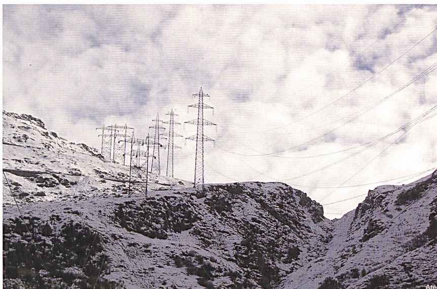
Bild 3 380-kV-Leitung über den Nufenenpass
