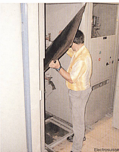
Fig. 8 La plaque est trop large et ne peut être introduite... et où est l'équipement de protection individuelle? (situation simulée)
