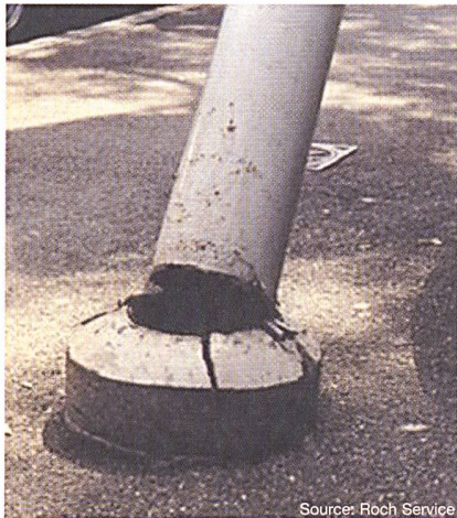
Figure 3 Fatigue et corrosion ont tendance à se développer dans les parties non visibles du fût
