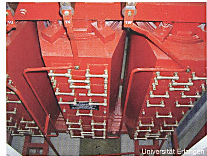
Bild 1 Oberspannungsseite des Hochstromtransformators
