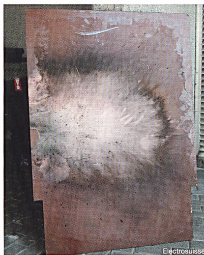
Bild 9 Kupferdampf hat sich auf die Platte niedergeschlagen. Glücklicherweise hat die Platte den Monteur doch etwas geschützt.
