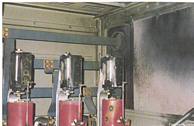
Bild 15 Der Netzelektriker wollte versehentlich von Hand den unter Spannung stehenden 16-kV-Hauptstrom-Überstromauslöser zurückstellen
