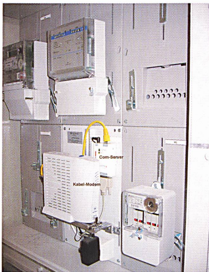
Kommunikationseinheiten (Comserver und Kabelmodem) sowie Lastgangzähler.
