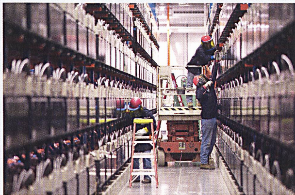
Das Energiespeichersystem ist grösser als ein Fussballfeld.
