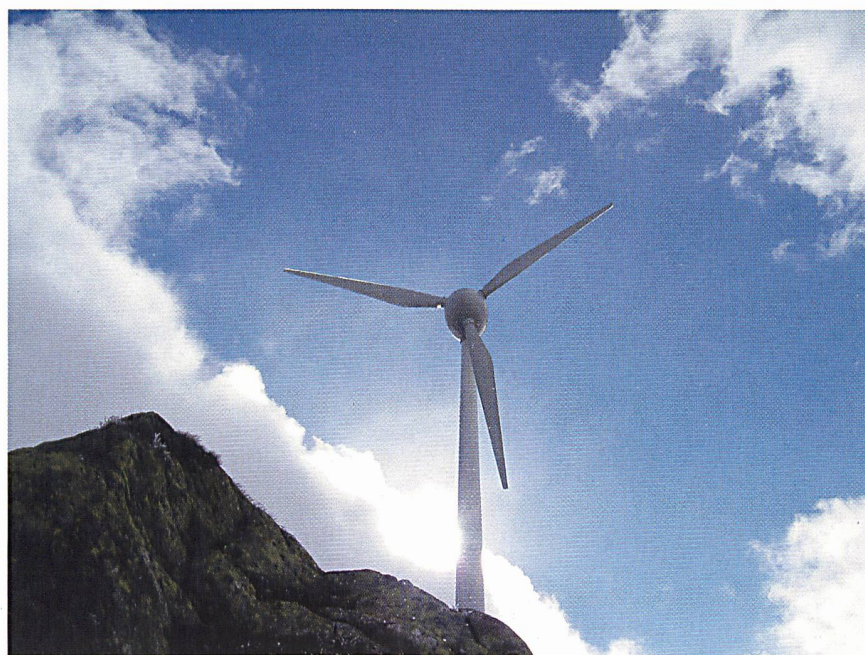
Die neue Anlage auf dem Güttsch ob Andermatt (UR, Bild Suisse-Eole).
