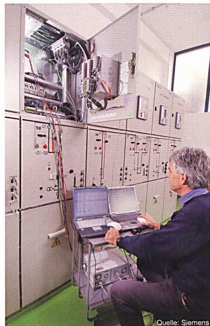
Bild 1 Unterwerk Winznau Schachen nach IEC 61850
