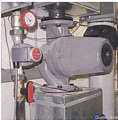
Bild 10 Pumpenaustausch durch richtig ausgelegte Magnetmotorpumpe
