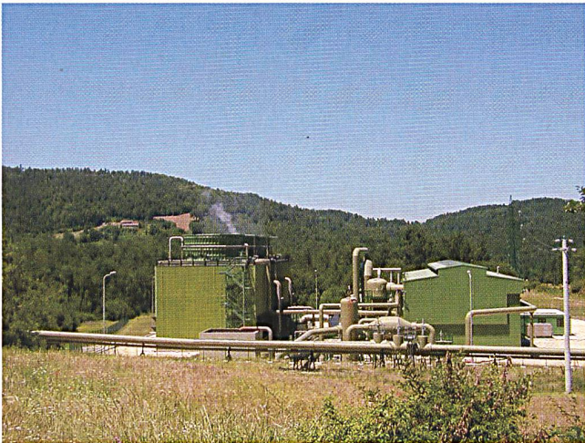
Anlage Travale im Gebiet Larderello.
