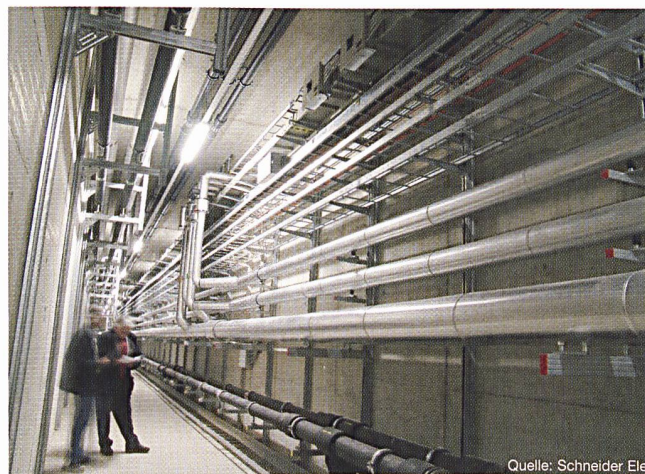
Bild 4 Die Stromschienen führen durch den 1 km langen Tunnel zum Dock E
