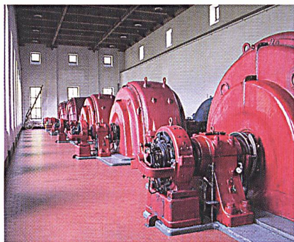
Im Kraftwerk Küblis sind fünf Turbinengruppen in Betrieb. Zwei davon produzieren einphasigen Bahnstrom (Bild: repower).
