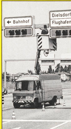
Korrosionsschutz an Signalanlagen
