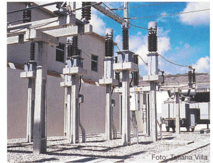
Versorgung Werk Potiguar Natal: Hochspannungsanlage 69 kV und Transformator 5 MVA 69/13,8 kV
