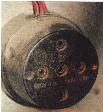
Ohne Prüfen der Übereinstimmung wurde der Stecker mit zentralem Schutzleiter-Anschluss in diese Buser-Steckdose eingeführt Sans contrôle de concordance, la fiche à raccord central de protection a été introduite à cette prise Buser
