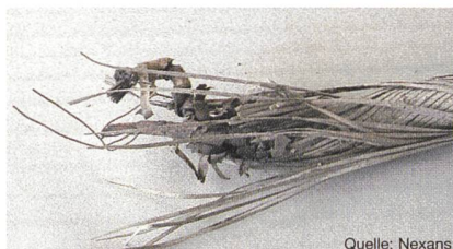
Bild 3 Teil der gerissenen Stelle
