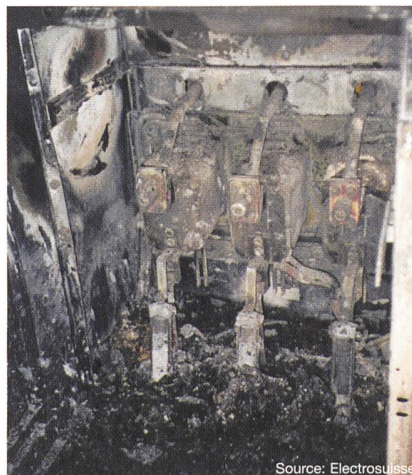
Figure 11 Cellule de couplage MT entièrement détruite par le court-circuit
