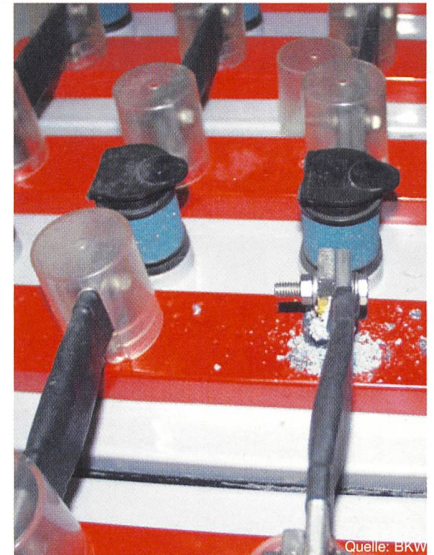
Bild 3 Korrosion an den Anschlüssen
