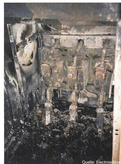
Bild 11 Durch den Kurzschluss vollständig zerstörte MS-Schalterzelle
