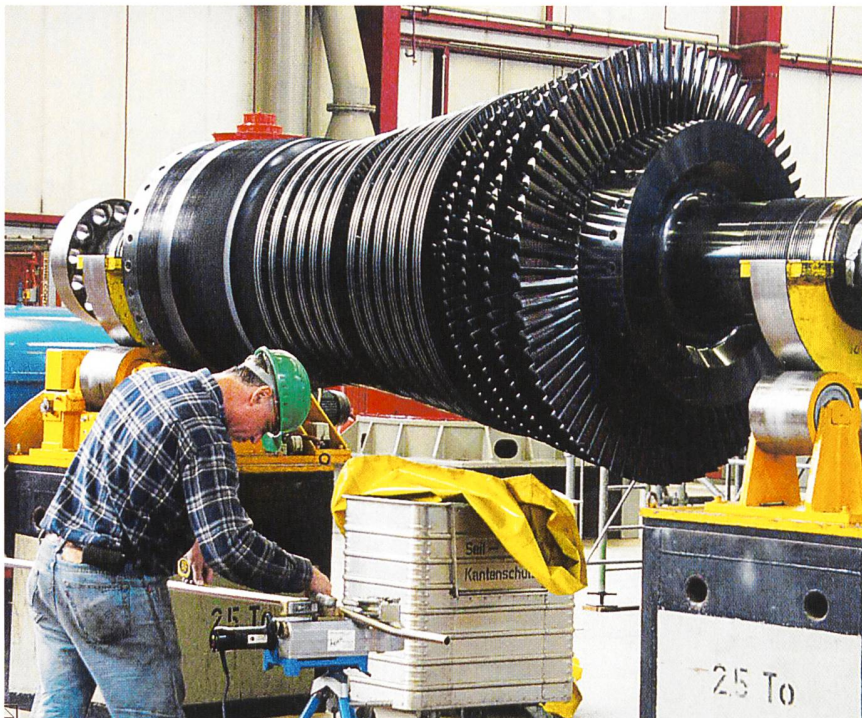
Jedes Jahr werden im Sommer die Kernkraftwerke für die Prüfung wichtiger Komponenten und Systeme sowie zum Ersatz von Brennelementen abgestellt. Oben: Eine der beiden Hochdruckturbinen von Block 1 des KKB wurde revidiert. Beide Kernkraftwerke Beznau I und II sind wieder in Betrieb (Bild: nok).
