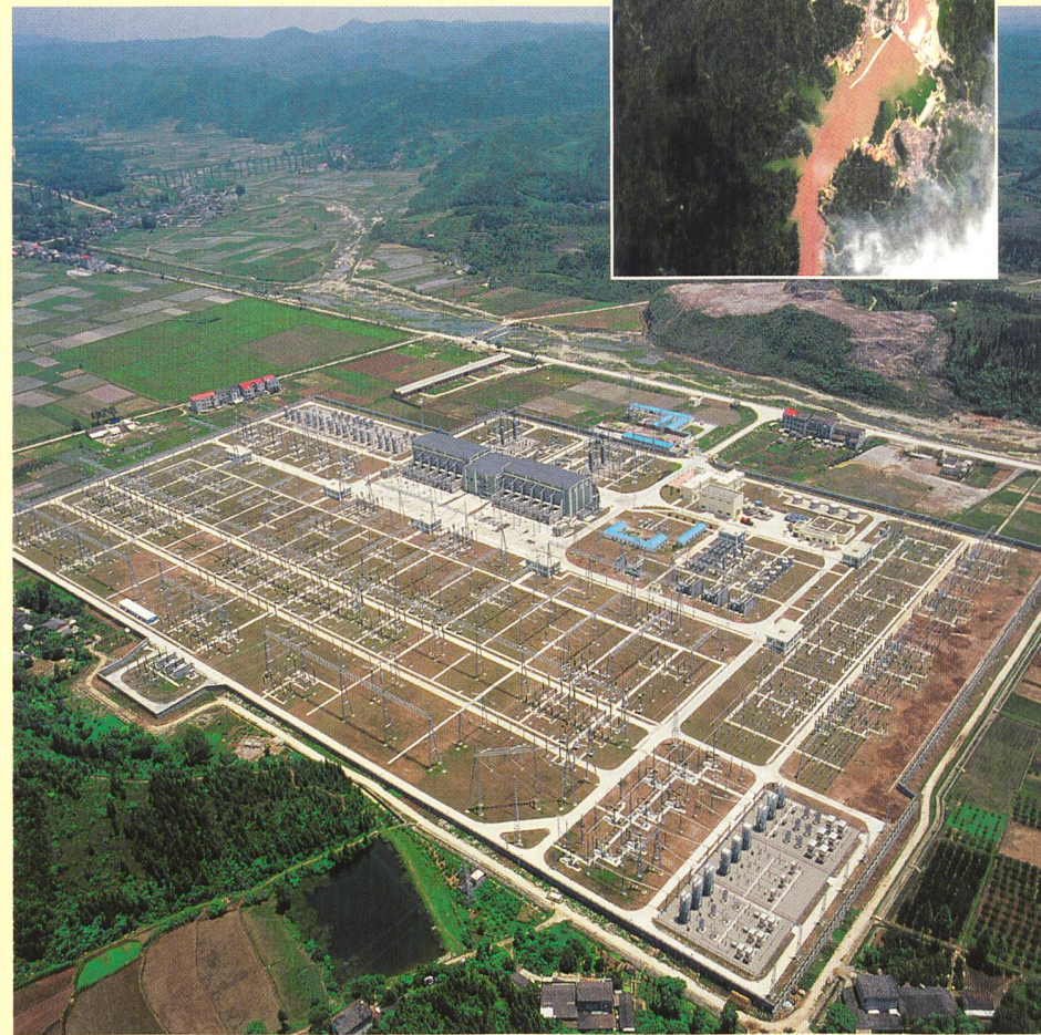
Umrichterstation Longquan als Teil der Hochspannungs-Gleichstrom-Übertragungsanlage zum «Dreischluchten-Kraftwerk». Es hat die Grösse von 42 Fussballfeldern (Foto: ABB).
