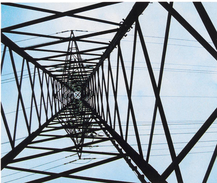
Strommast von innen (Bild: REpower).
