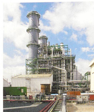
720-MW-GUD-Anlage Phu My 3 (Bild Siemens).
