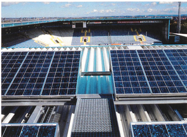
Mit dem Solardach Geld verdienen? Solarstrom-Anlage auf Bielefelder Fussballstadion (Bild SMA Regelsysteme/UVS).
