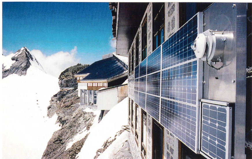
Bild 1 Blick auf die eine Hälfte des Solargenerators der PV-Anlage (1,1 kW_p ) an der Fassade der hochalpinen Forschungsstation Jungfrauoch (3454 m, etwa 46,5°N). Am rechten Bildrand sind zwei Strahlungssensoren (ein Pyranometer und eine Referenzzelle) zu erkennen.
