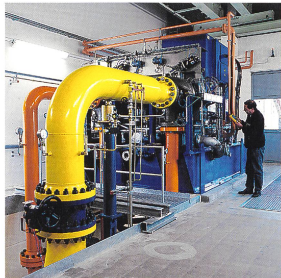
Entspannungsanlage (Bilder: ebm).
