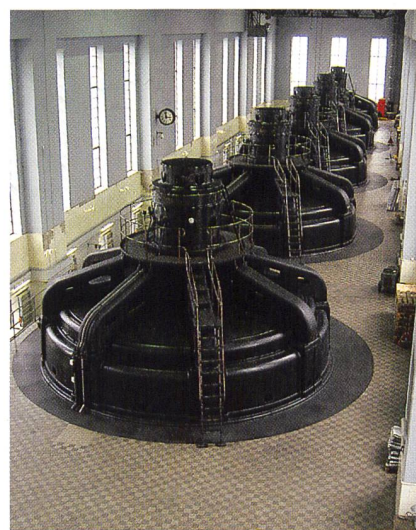
Chancy-Pougny: salle des machines avec les 5 groupes turbines-alternateurs actuels (photos: sfmcp)
