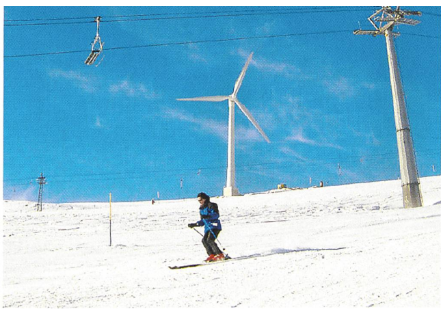
Windanlage auf dem Gütsch ob Andermatt.
