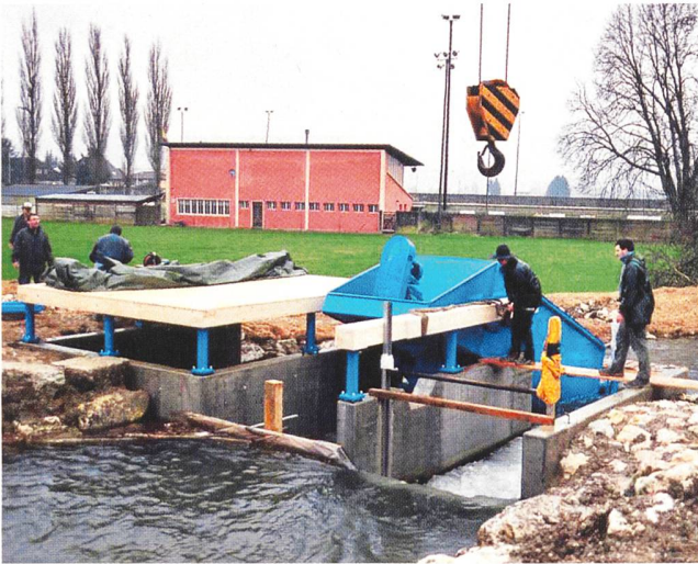
Montage der kompakten Einheit der Wasserkraftschnecke im Grützbach bei Derendingen (SO).
