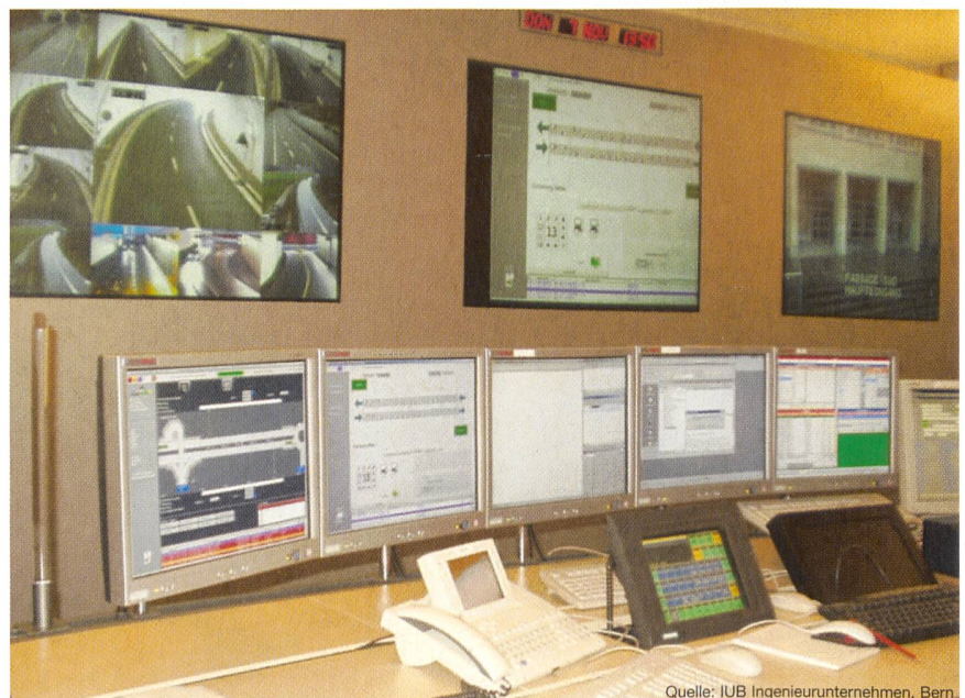
Bild 1 Detailaufnahme Bildschirm mit Tunnelstreckenausschnitt
