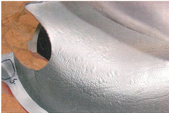
Bild 3 Ein weiterer Schadensmechanismus ist der Tropfenschlag. Dabei schlagen Wassertropfen, weil sie immer wieder auf die selbe Stelle im Laufrad geschleudert werden, Dellen aus dem Laufrad heraus. Die Ursache kann in einem divergierenden Strahl liegen, der an seiner Aussenseite «ausfranst», kann aber auch von einer stumpfen Mittelschneide herrühren, die bewirkt, dass der Strahl nach Aufprall auf der Schneide sich teilweise in Tropfen auflöst.
