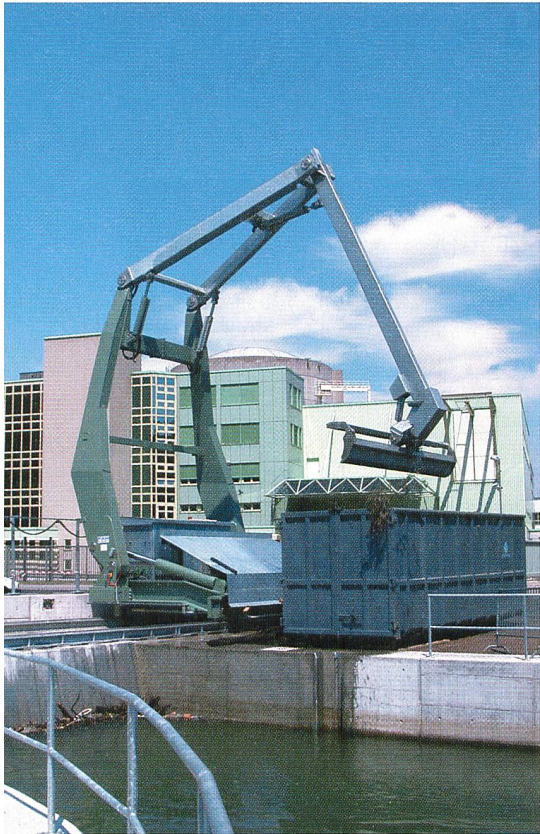
Die Greiferharke befreit den Rechen vom Geschwemmel (Photos Axpo/NOK).
