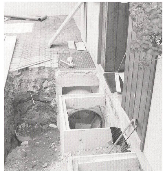
Bild 2 Die als Wärmequelle dienende Aussenluft wird im Eingangsbereich gewonnen und über wärmeisolierte Blechkanäle direkt zur Anlage im Keller geführt. Nach Abschluss der Arbeiten sind heute vom Luftein- und -auslass nur noch diskrete bodenebene Gitter beidseits der Eingangstür zu sehen. (Quelle: SIG)
